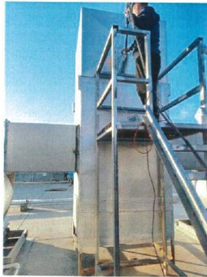
喷漆工序 1#废气处理后排放口
