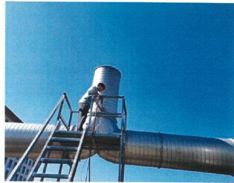
喷漆工序 4#废气处理后排放口
