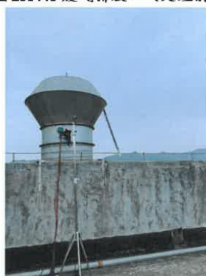
FQ-290441 废气排放口（处理后）
