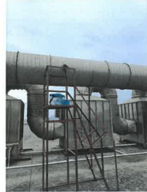
FQ-290443 废气排放口 (处理后)
