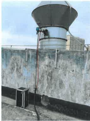
FQ-290442 废气排放口 (处理后)
