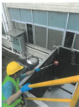
1#废水集水池（处理后）
