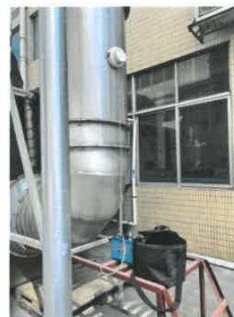
FQ-290439 废气排放口（处理前）
