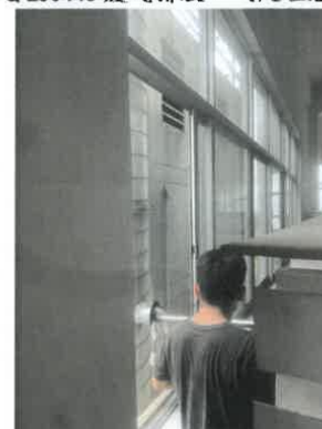
FQ-290442 废气排放口（处理前）
