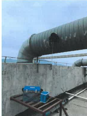
FQ-290443 废气排放口 (处理前)
