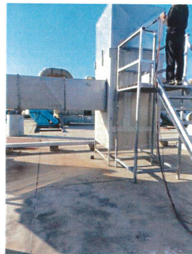
喷漆工序 2#废气处理后排放口
