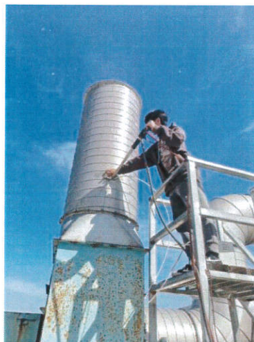
喷漆工序 5#废气处理后排放口
