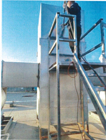
喷漆工序 1#废气处理后排放口
