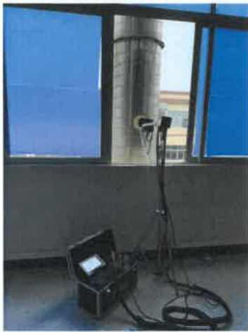
FQ-290438 废气排放口
