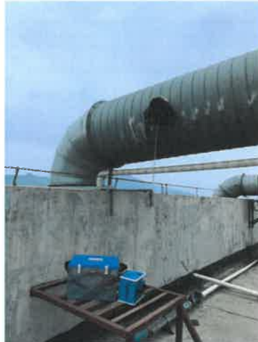
FQ-290443 废气排放口 (处理前)
