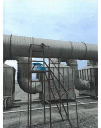
FQ-290443 废气排放口 (处理后)
