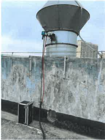
FQ-290442 废气排放口 (处理后)
