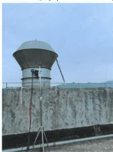
FQ-290441 废气排放口（处理后）
