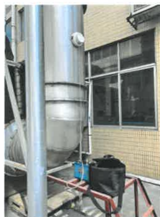
FQ-290439 废气排放口（处理前）
